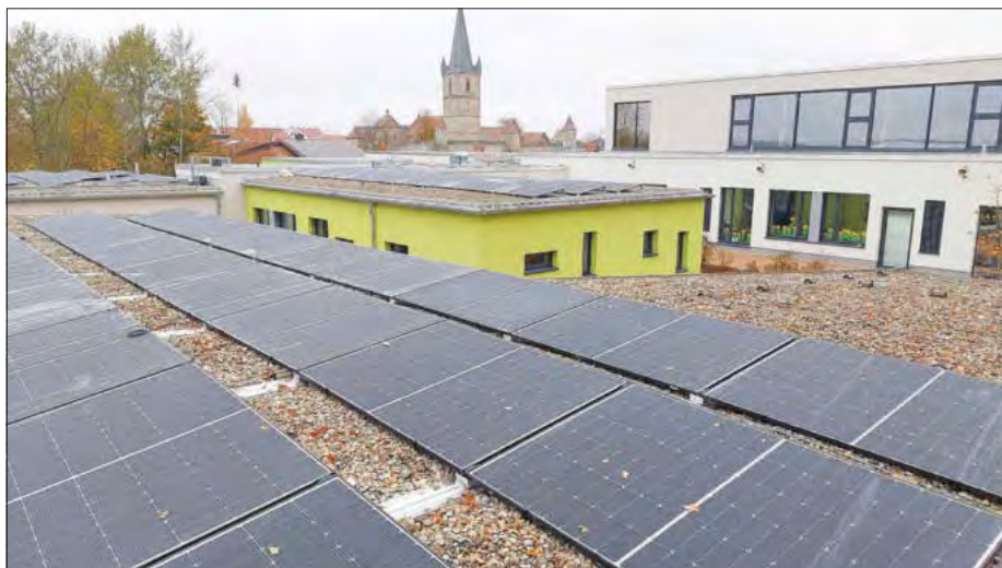
Auch die Gemeinde Heßdorf erzeugt umweltfreundlichen Strom durch PV-Anlagen, wie etwa hier auf dem Dach der Grundschule Hannberg.
