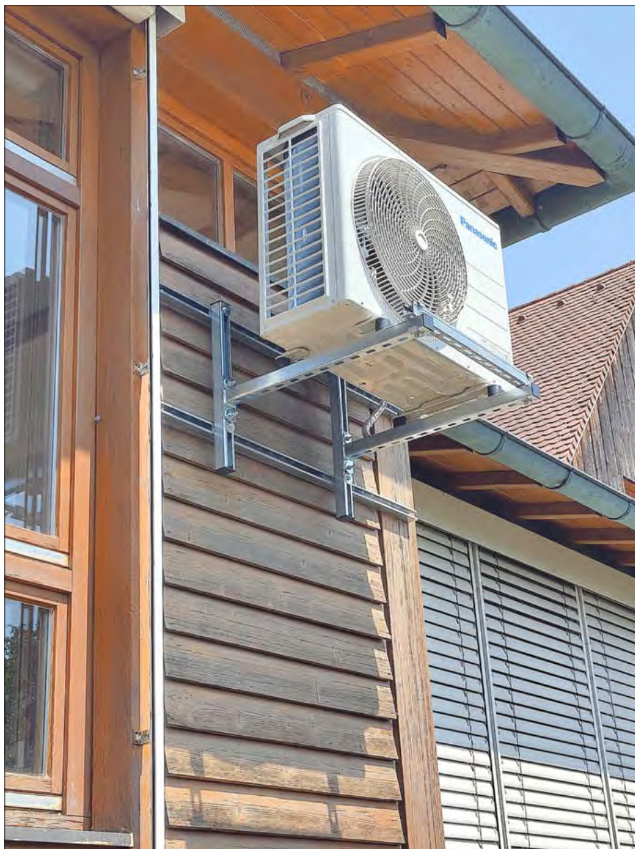
So sieht die Installation des Split-Klimagerätes von außen aus.
